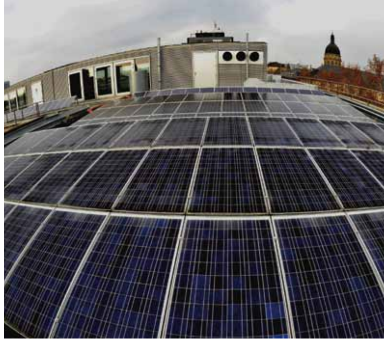
Strom vom Dach durch Sonnenkollektoren.
